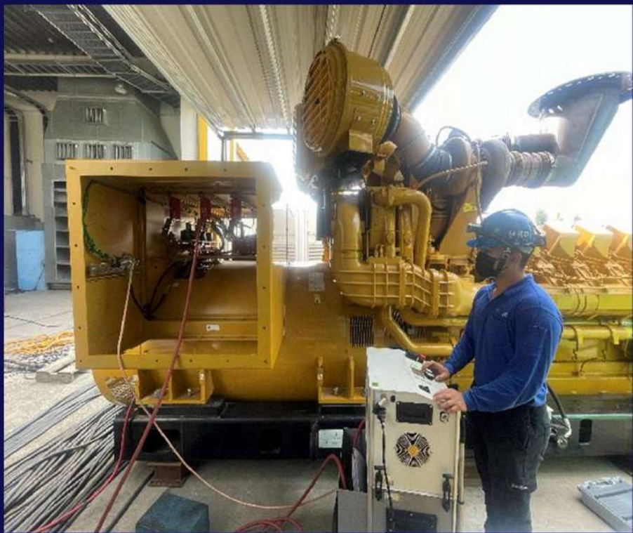
高壓發電機耐壓測試 配合廠測
