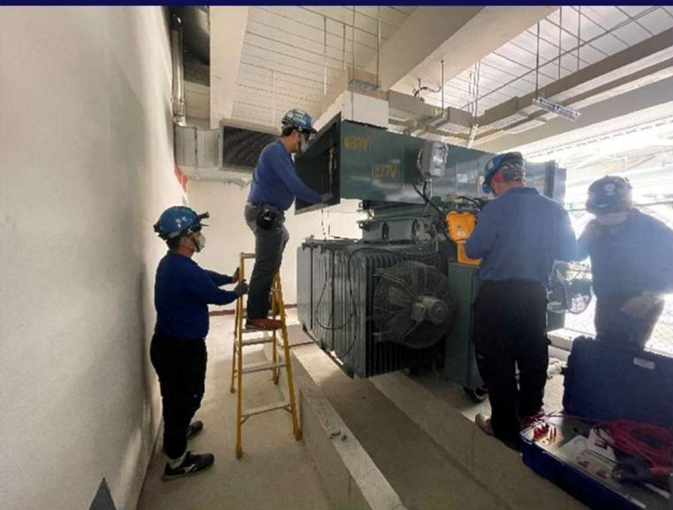
變壓器匝比量測
