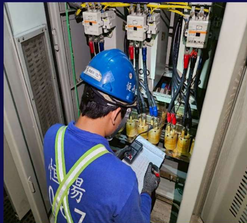
低壓盤電容器電容值量 測
